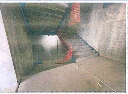
f1 Barandales y sellos, escaleras servicios Anterior
